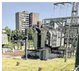
„Hidden Waves“: Christina Kubisch entlockte dem Umspannwerk am Mehlpfad Klänge, indem sie Elektrizität in eine Komposition verwandelte.
